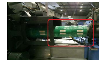
赤囲い部分：放熱対策
